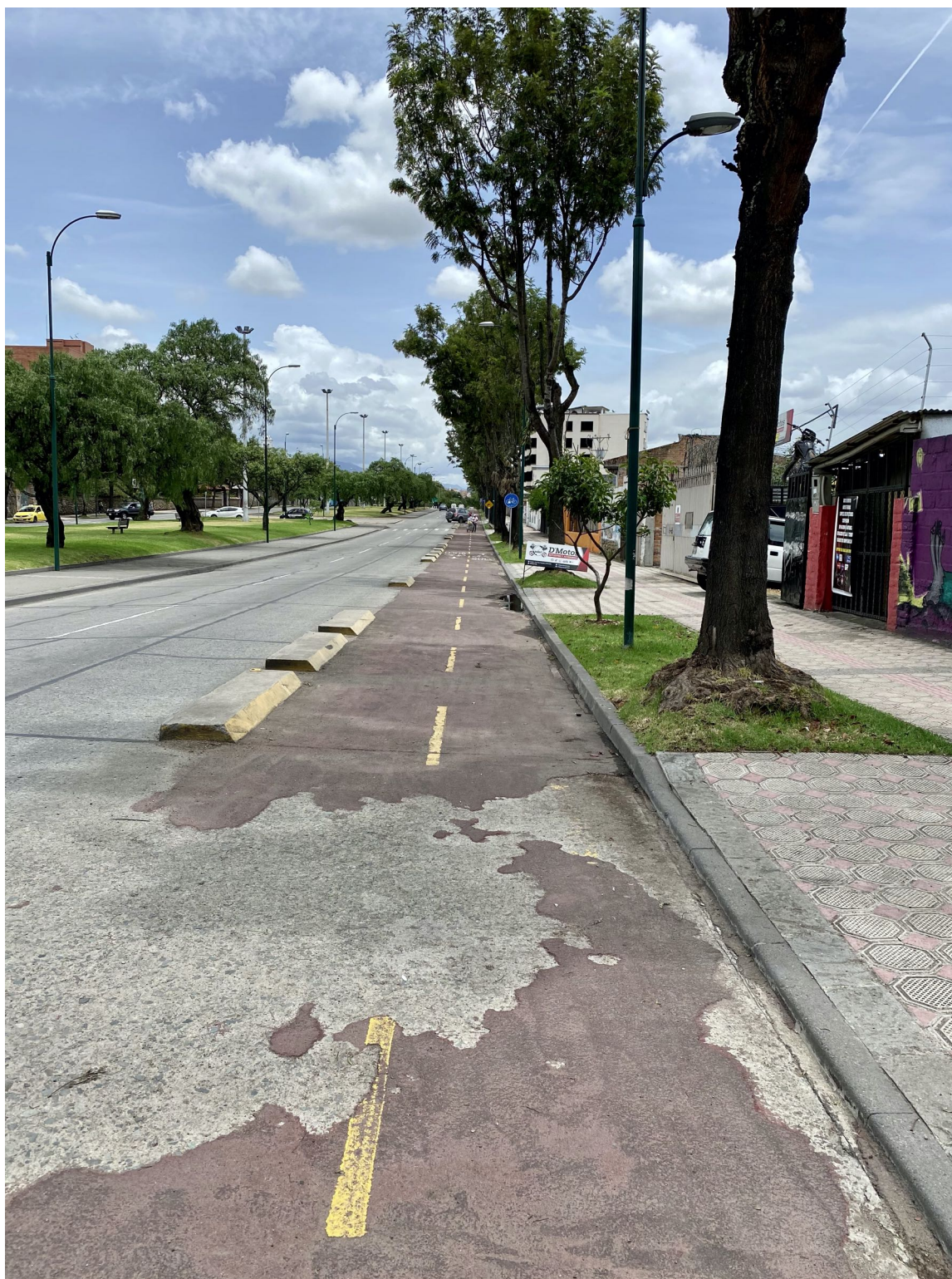
FIGURA 3.5: Capa de rodadura de ciclovía en mal estado. 2020.
