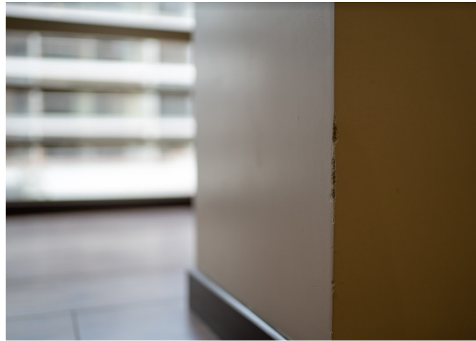
Rajadura en columna
