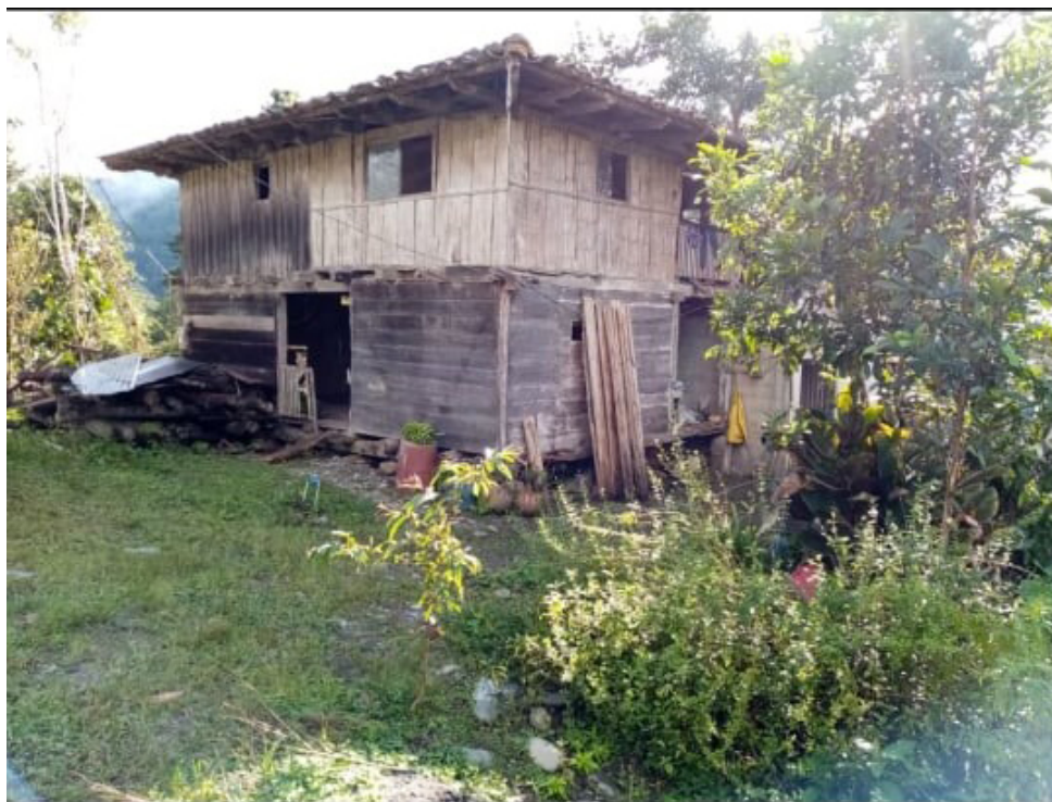
FIGURA 1.1: Vivienda en Estado Irrecuperable.
