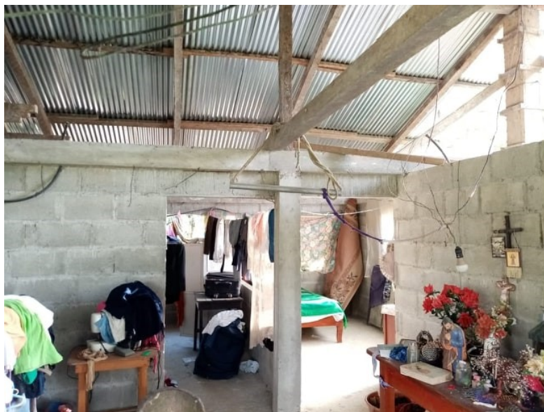
FIGURA 1.2: Vivienda en Déficit Cualitativo.
