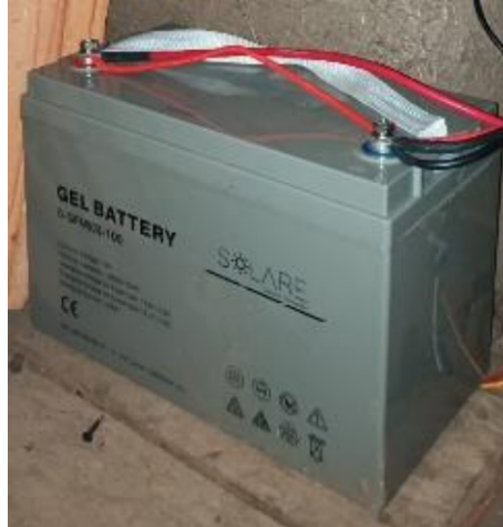
Figura 24 Batería VRLA BATTERY de 12V y 100Ah. Fuente (Miguel Siguencia, Santiago Salto, Autor).
