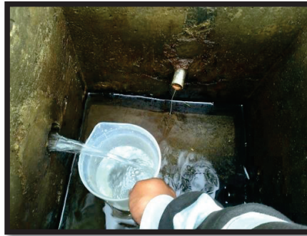
Fig. 17 Tanque receptor de la captación
