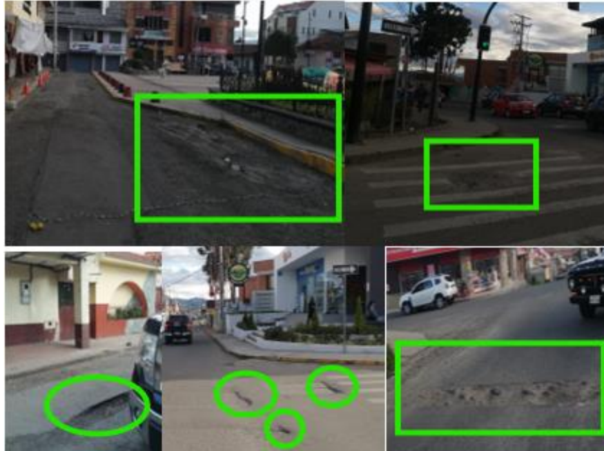
Ilustración 17: Hundimiento, hinchazón, huecos y grietas en la calzada. Fuente: Autor.
