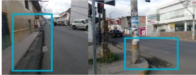
Ilustración 20: Estado de las cunetas. Fuente: Autor.
