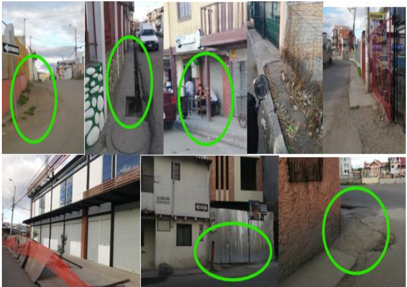
Ilustración 19: Estado de las aceras en la parroquia. Fuente: Autor.
