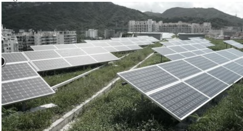
Figura 2.24: Paneles solares instalados en la cubierta del edificio.
