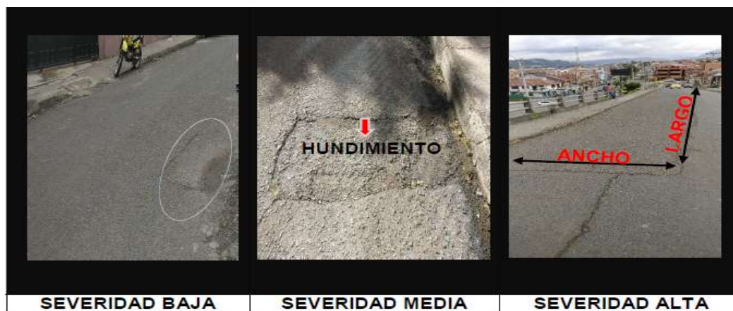
Figura 21: Abultamientos y Hundimientos.
