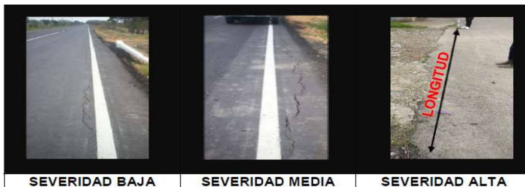
Figura 24: Grieta de Borde.
