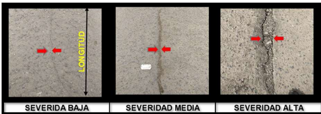
Figura 27: Grieta Longitudinal Y/O Transversal.
