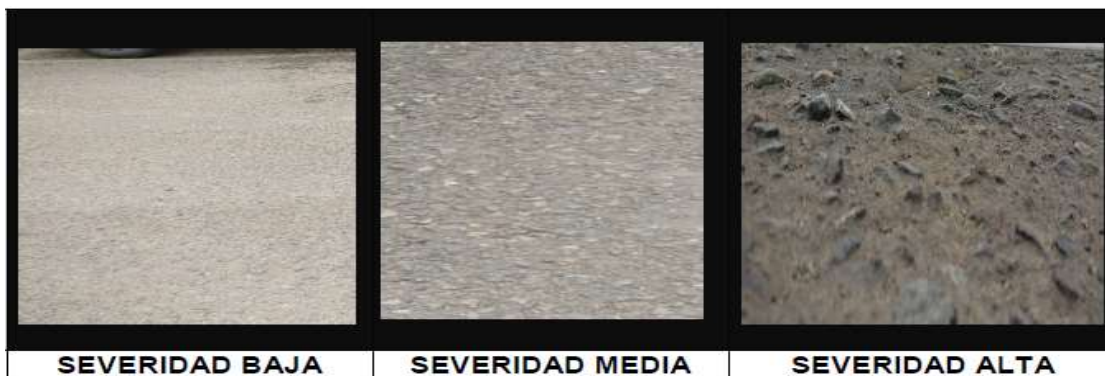
Figura 31: Desprendimiento de Agregados.
