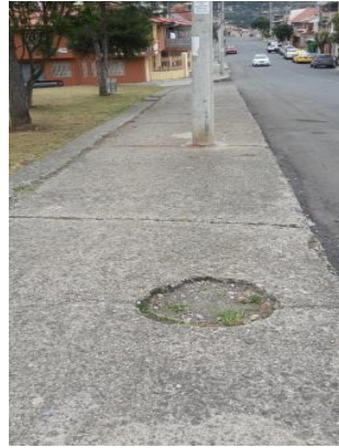
Fotografía N° 4 Acera Lateral Deteriorada
