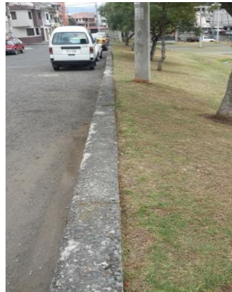
Fotografía N° 7 Acera Superior Deteriorada
