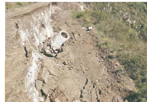
Deslizamiento afecta alcantarillado
