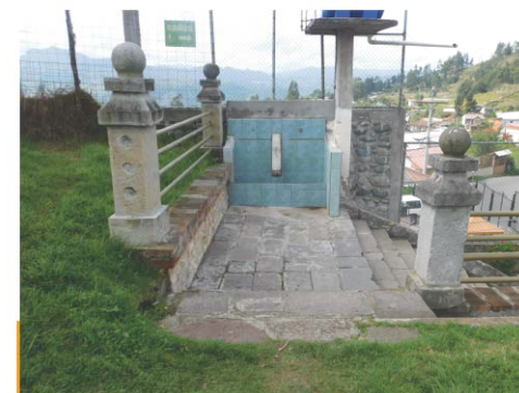
Escaleras sin rampas de acceso
