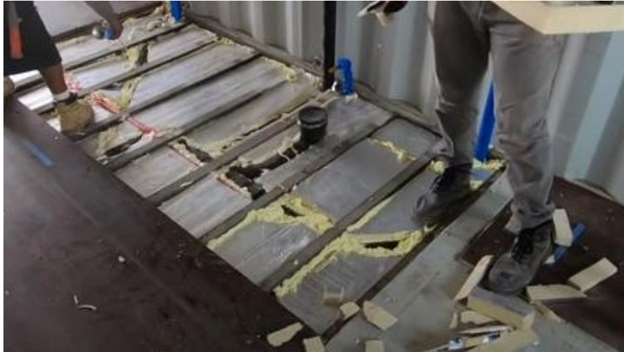
Figura 78: Instalaciones en contenedores
