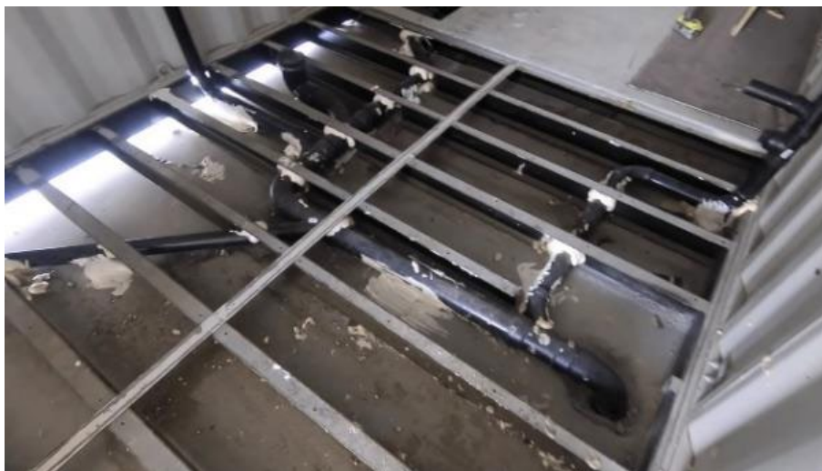
Figura 77: Instalaciones en contenedores
