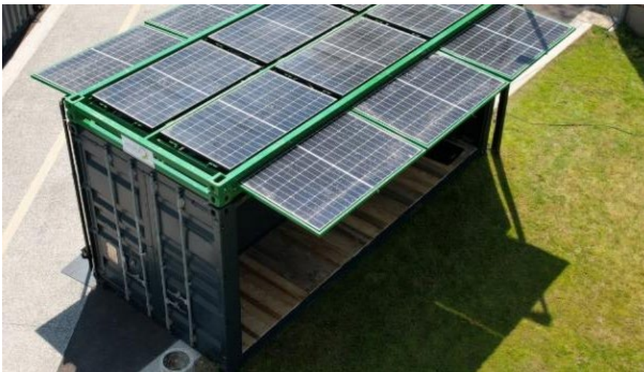
Figura 87: Sistema de energía solar
