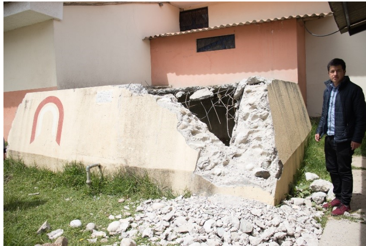
FIGURA 1.8: Tanque de reserva de agua de la comunidad de Guncay
