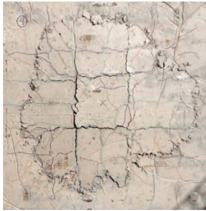
Figura 22. Fisuras por punzonamiento en losa
