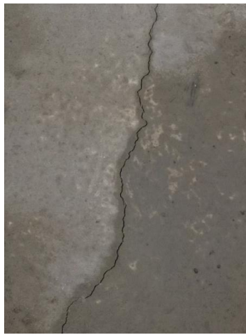
Figura 14. Grieta por contracción plástica en losa
