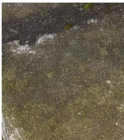
Figura 8. Algas, líquenes y musgos adheridos en el hormigón
