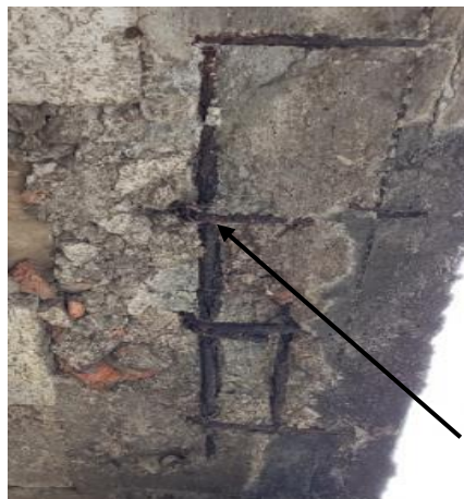
Figura 29. Carbonatación en losa de hormigón
