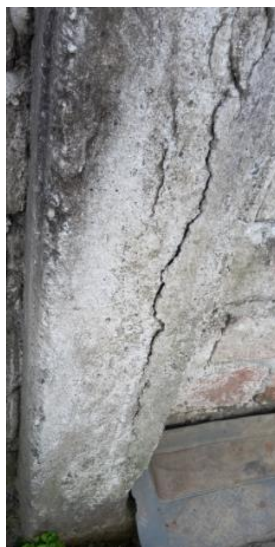
Figura 23. Fisuras por compresión en columna
