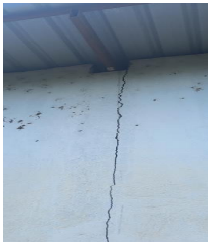
Figura 17. Fisura por tracción en la unión de columna con la mampostería
