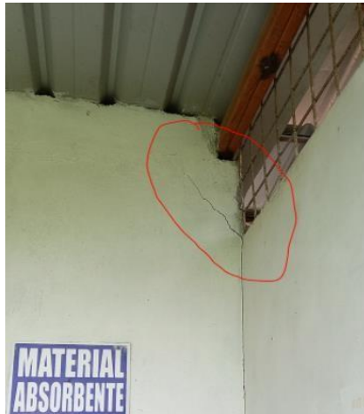
Figura 19. Fisura por cortante
