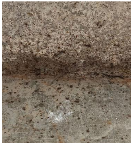
Figura 7. Hongos (Mohos) adheridos en el hormigón
