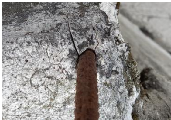
Figura 20. Fisuras por adherencia entre hormigón y acero de refuerzo
