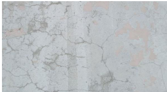
Figura 13. Fisuras por dilatación y contracción higrótérmica
