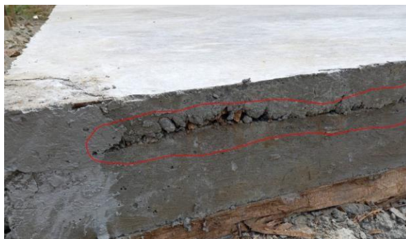
Figura 31. Junta fría en losa
