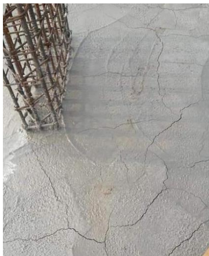
Figura 15. Grieta por contracción por secado en losa
