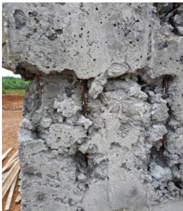
Figura 30. Coquera en columna
