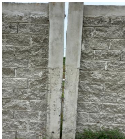
Figura 11. Desplome de columnas
