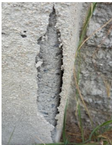
Figura 24. Desprendimiento en columna
