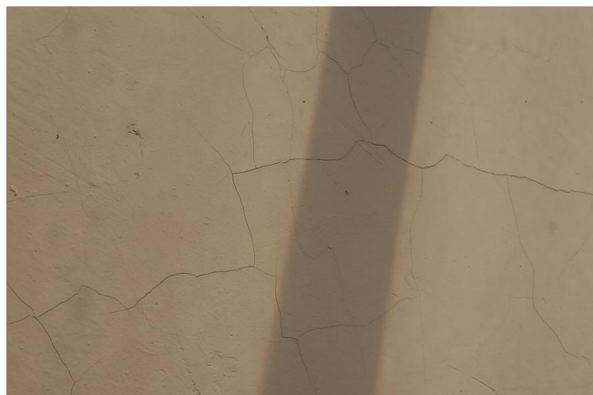
Figura 4. Fisuras capilares o superficiales
