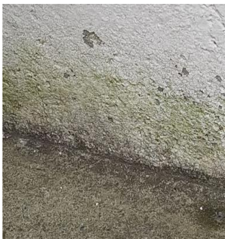
Figura 6. Bacterias adheridas en el hormigón
