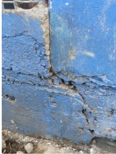
Figura 21. Fisura por torsión en viga de cimentación
