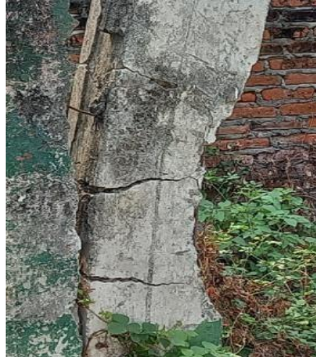
Figura 18. Fisura por flexión en columna.
