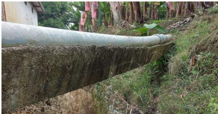
Figura 12. Alabeo en viga
