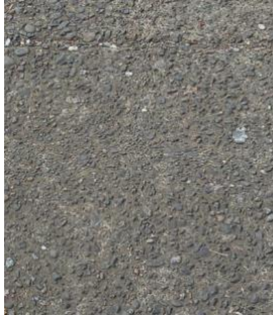
Figura 25. Erosión mecánica de pavimento.
