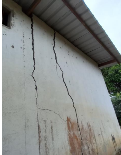
Figura 16. Grietas por asentamiento diferencial en pared
