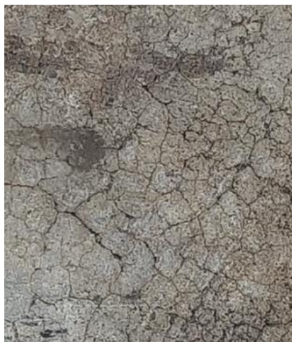
Figura 5. Fisuras de contracción por secado.
