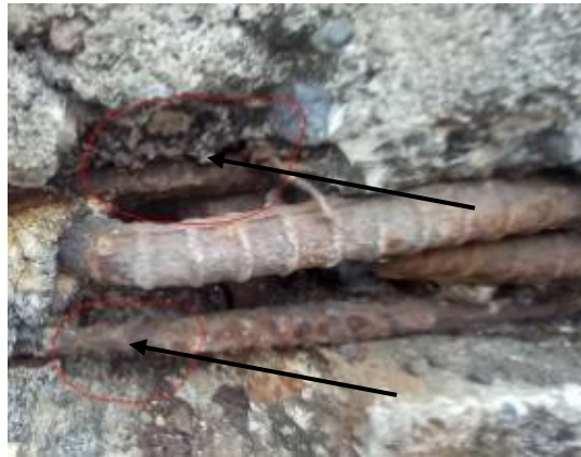
Figura 28. Oxidación y corrosión en armadura de refuerzo
