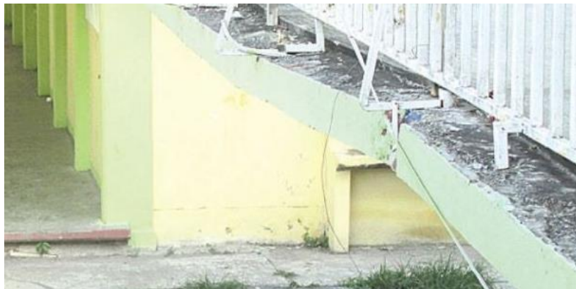
Figura 9. Flecha en viga
