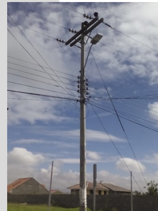
Foto 18. Ejemplo de servicio eléctrico eléctrico
