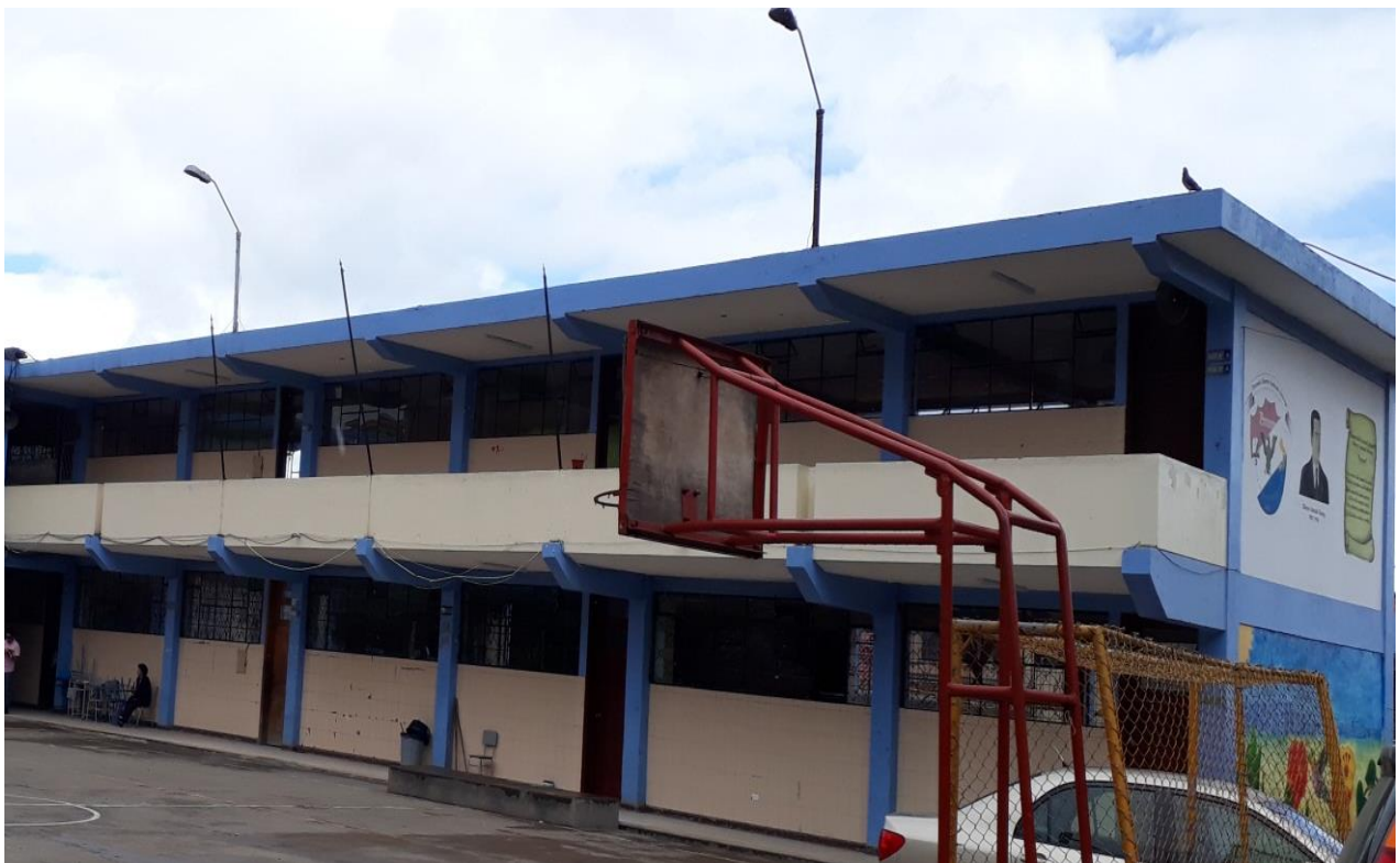
Figura: 3. Elementos estructurales principales del bloque 1 de la Unidad Educativa “Alberto Andrade Arízaga, Brummel”.
