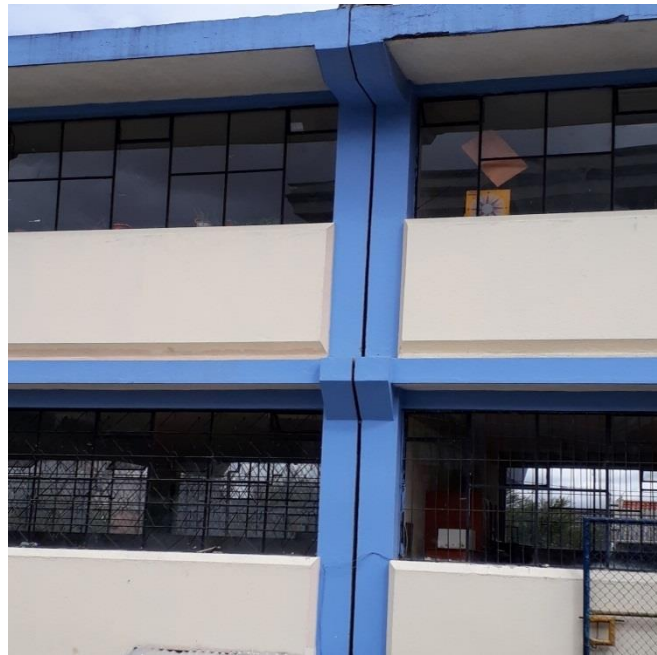
Figura: 13. Junta de dilatación entre bloques de la Unidad Educativa “Alberto Andrade Arízaga, Brummel” Fuente: Autor
