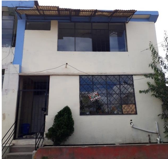
Figura: 6. Elementos estructurales principales del bloque 4 de la Unidad Educativa “Alberto Andrade Arízaga, Brummel”. Fuente: Autor
