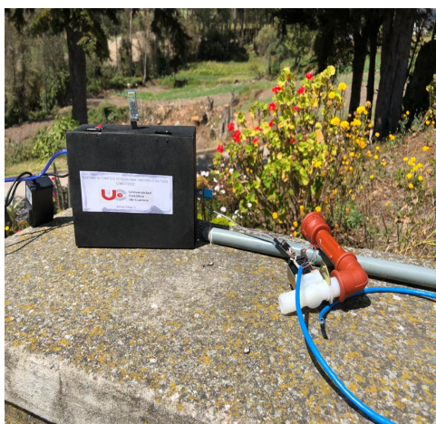
Figura 3.17: Acoplamiento del sistema electrónico con el sistema de cañerías
