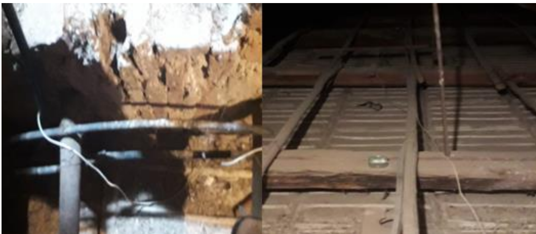
Fig. 20 Estado del sistema eléctrico
