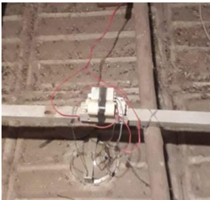
Fig. 21 Transformador de mercurio
