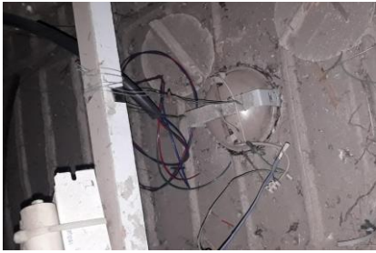
Fig. 1 Estado del sistema eléctrico de iluminación
