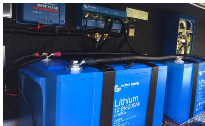
Ilustración 12. Batería o banco de baterías.
