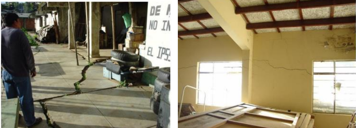
Figura 16. Imágenes reales por asentamientos diferenciales en suelos expansivos.
