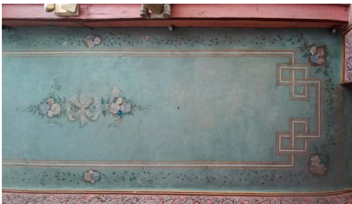
FIGURA 2.11: Casa de las Palomas, cielorraso de yeso pintado en Planta Baja, vista inferior. Fuente y elaboración: Autor.
