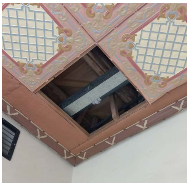
FIGURA 2.2: Pasaje Miguel León, estructura de sostén para cielorraso de latón. Fuente y elaboración: Autor.
