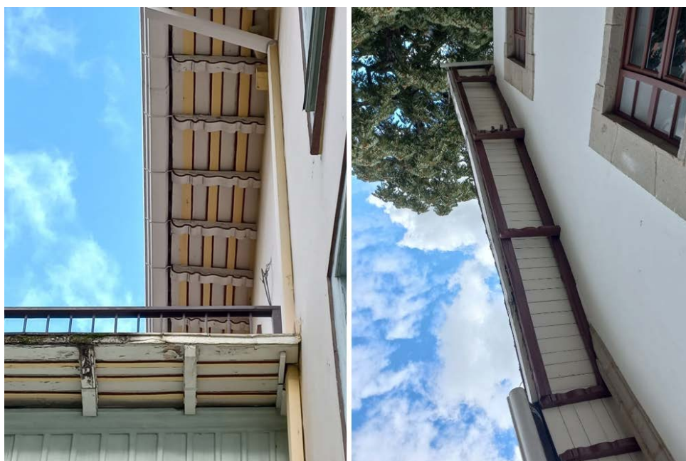
FIGURA 2.19: Museo de los Metales, aleros exteriores (izquierda). Museo del CIDAP, cielorraso exterior (derecha). Fuente y elaboración: Autor.
