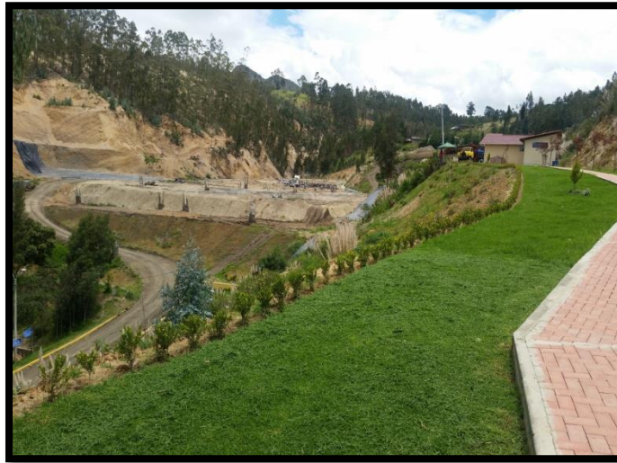
Fotografía No. 1. Relleno Sanitario con compactación mecanizada en la ciudad de Azogues
