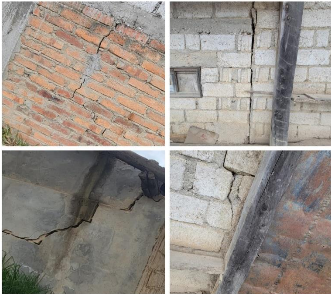
Fig. 18 Fallas estructurales en viviendas del S_18
