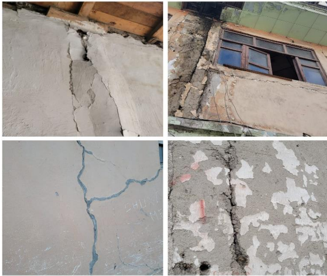
Fig. 17 Fallas en viviendas UMR en S_1
