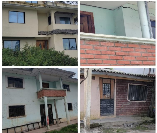
Fig. 20 Fallas en viviendas del sector 10 Correuro
