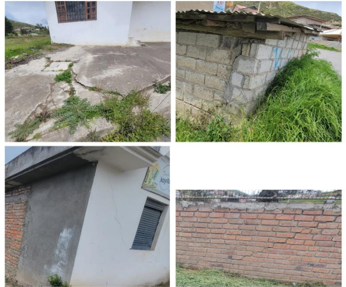
Fig. 19 Fallas de los sectores aledaños a la zona de riesgo
