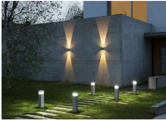
(A) Iluminación exterior de jardines
