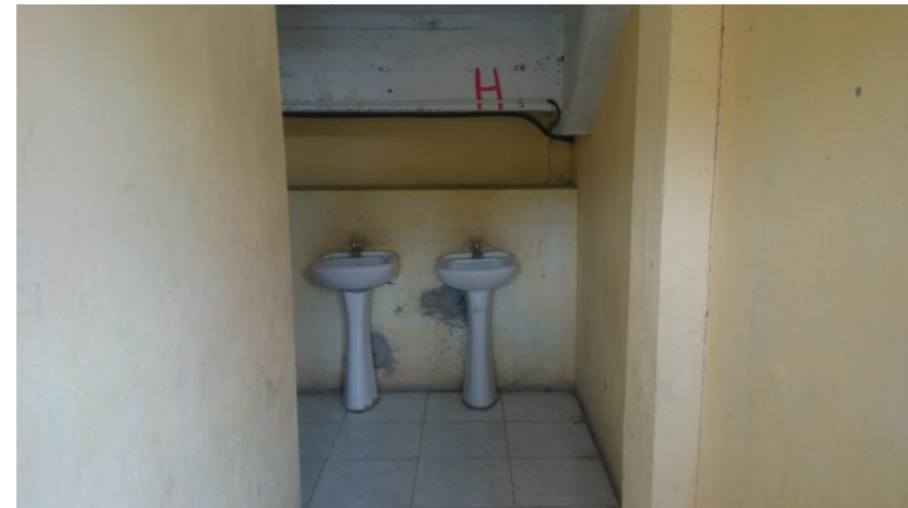
Fotografía N° 24. Lavabos con pedestal Actuales.
