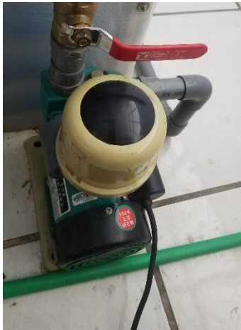
Ilustración 5. Bomba de recirculación del sistema biodigestor.
