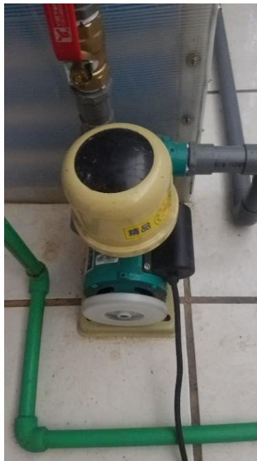
Ilustración 10. Sistema de recirculación de agua de la planta del biodigestor
