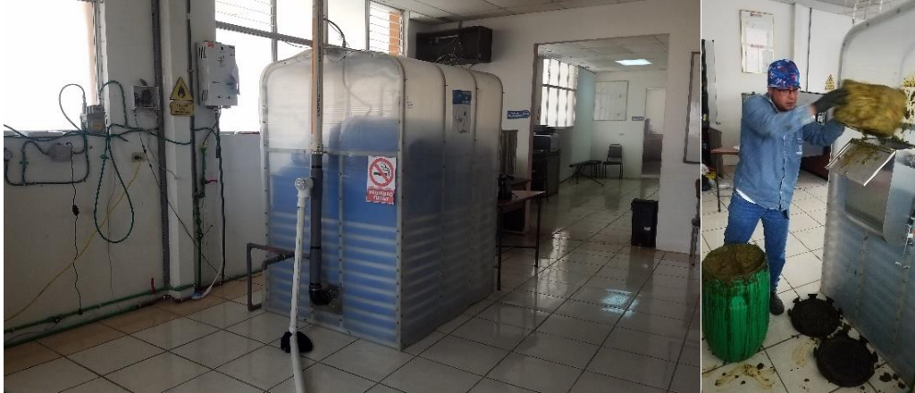
Ilustración 9. Ingreso de estiércol en el biodigestor.
