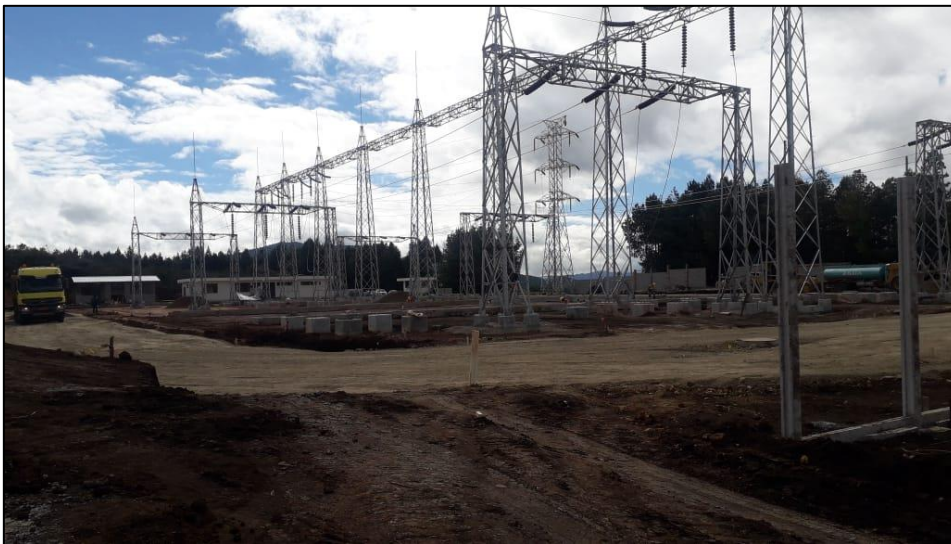
Fig. 7 Subestación de Seccionamiento La Paz a 138kV y su Línea de Transmisión.
