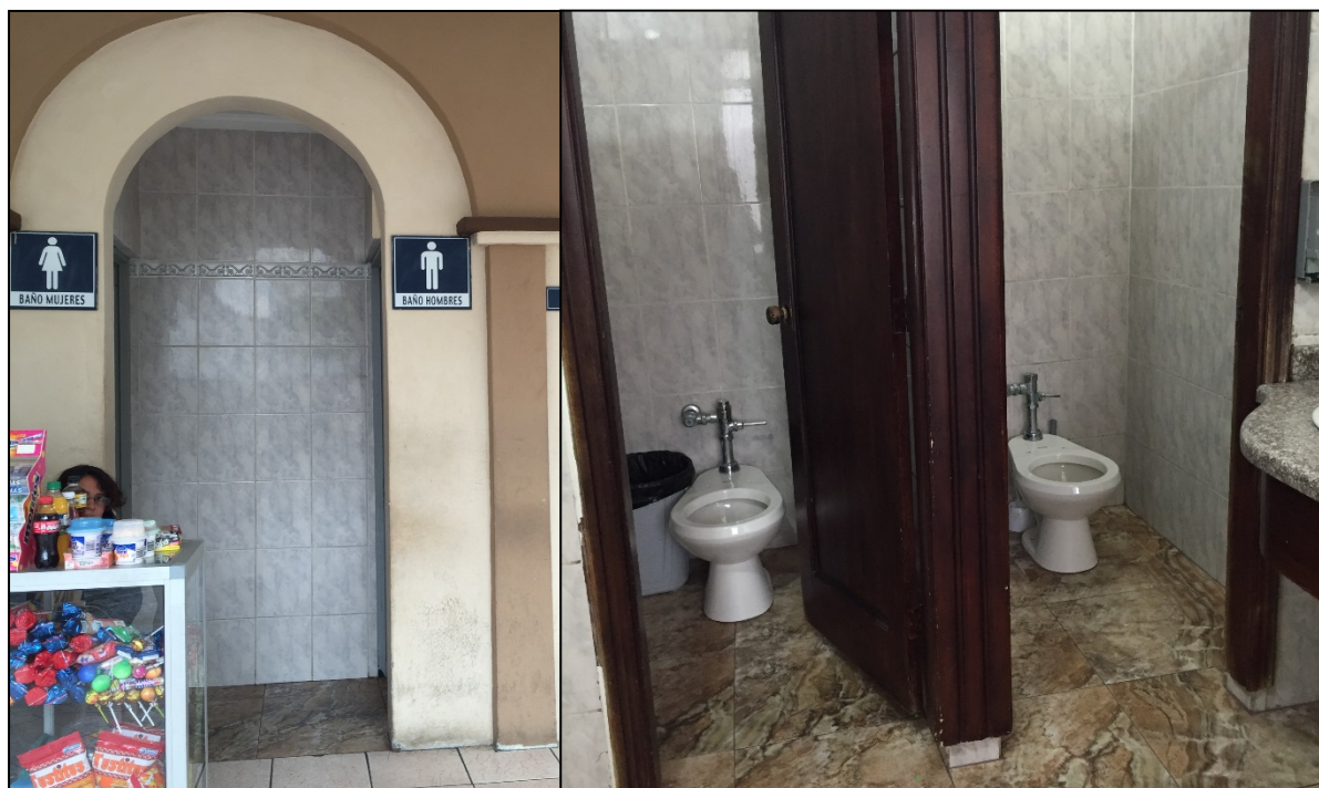
Foto 94 y 95: Baterías Sanitarias
