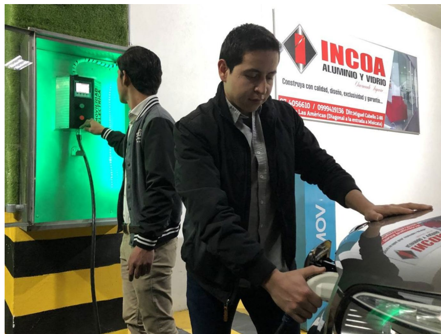
Fig 10. Electrolinera subterránea ciudad Cuenca
