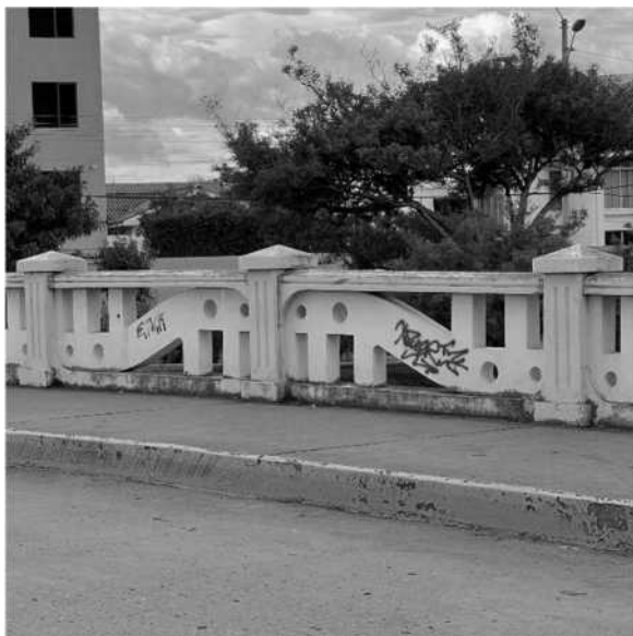
Figura 3.27: Zonas deterioradas. Fuente y elaboración: Propia.
