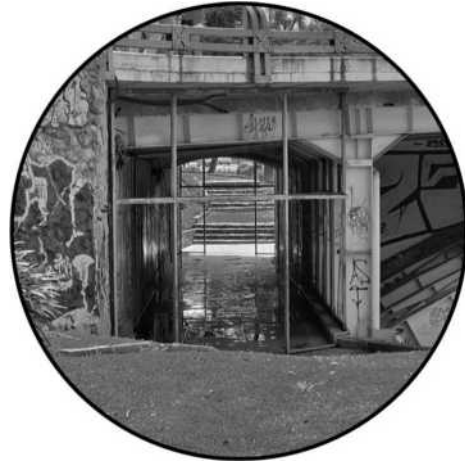
Figura 3.19: Falta de seguridad en el desnivel del puente. Fuente y elaboración: Propia.
