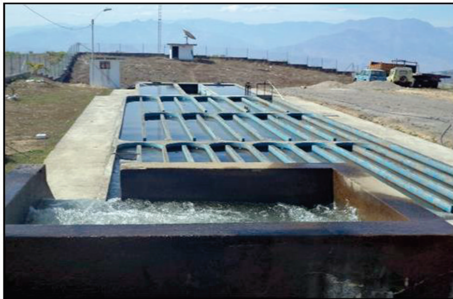
FOTOGRAFÍA 1: PLANTA PILANCON DE AGUAS POTABLE
