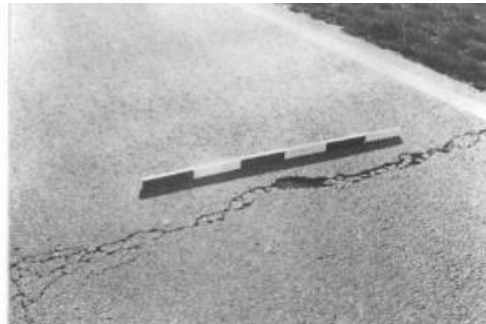
Figura 23. Fisuración transversal Fuente: (MOPC, 2016)
